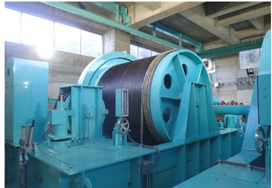
写真-4 新桂沢ダム新取水設備巻き上げ機
